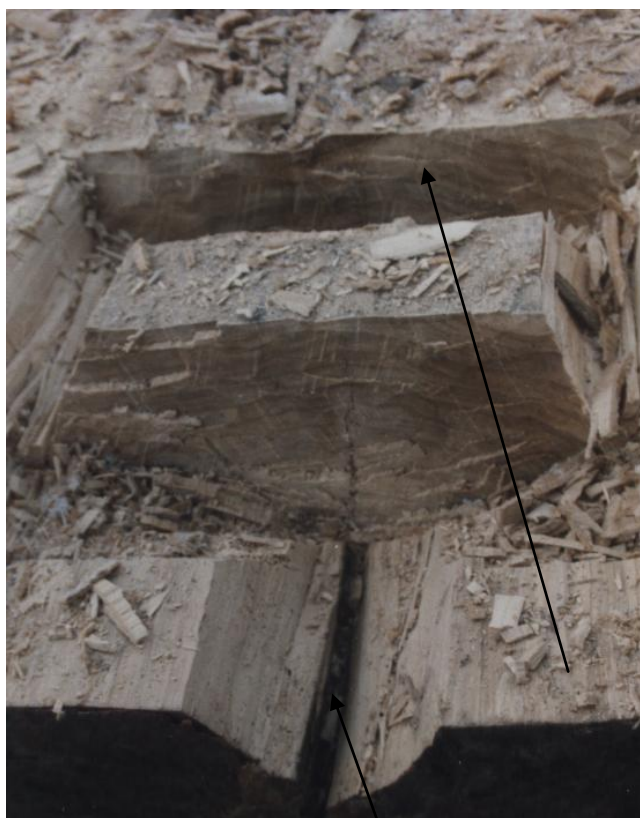
scheur nieuwe achterwand
